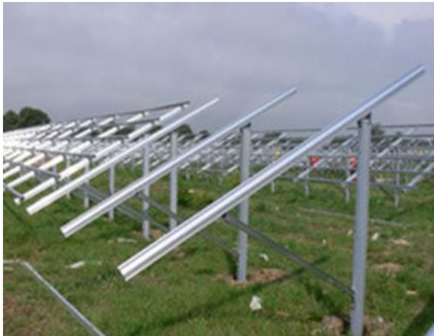
Figura nr.4. Structuri metalice panouri fotovoltaice
