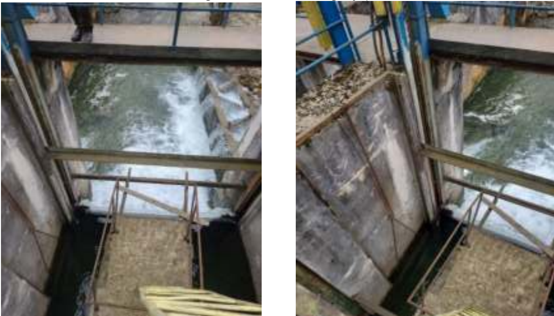
Fig. 6 - Vedere ansamblu mecanism de manevra, cu structura metalică, nisele metalice, și tije de acționare a stăvililor – prezintă uzura fizică și morală;
