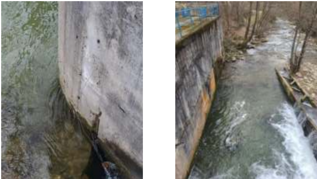
Fig. 8 - Culeele sunt protejate cu zid de beton care se prelungeste pe toată lungimea bazinului disipator
