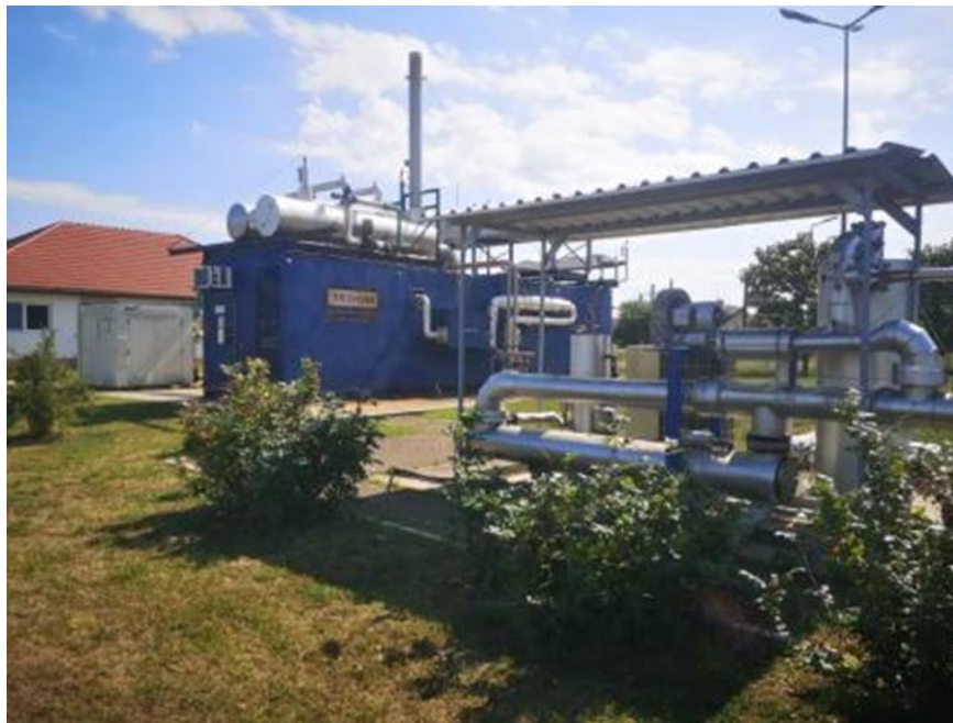
Stația de biogaz din orașul Săcueni (Foto – Consiliul Județean Bihor)
